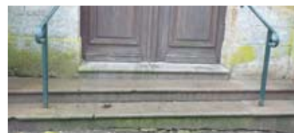
Une protection efficace contre les salissures des marches de l'église.
