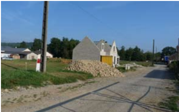
Les réseaux d'eau, d'électricité et de gaz terminés, les premières constructions démarrent rue du Rouge Biout, pour après, achever la voirie.
