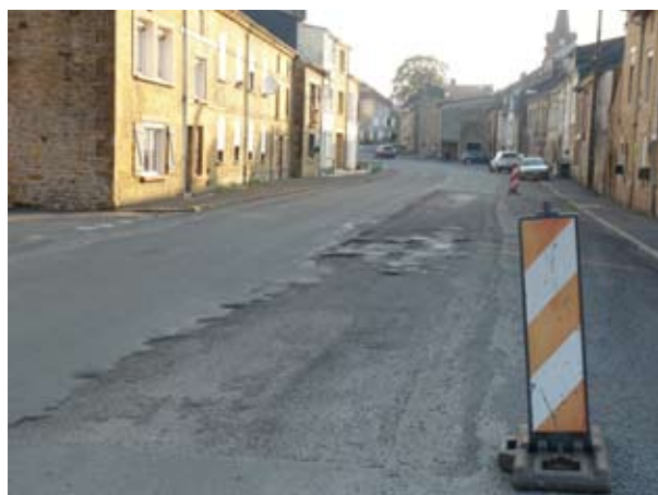
L'état de la traversée du village, 1 an après le gravillonnage
