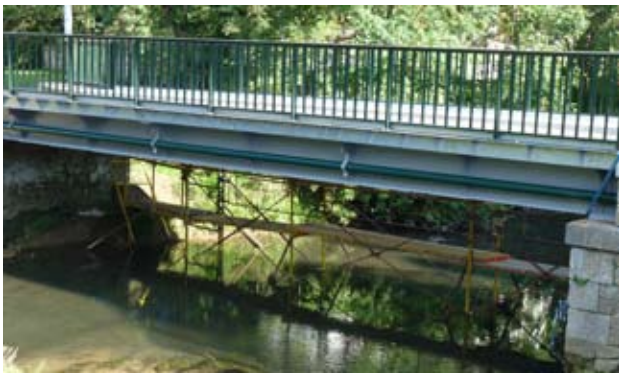
Après le garde corps et son trottoir, le tablier du pont est en cours de restauration, en attendant un nouveau revêtement.
